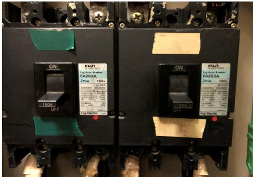
【遮断ブレーカー】
