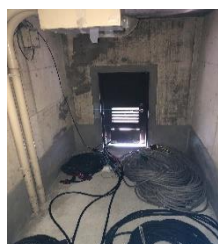
ケーブル処理室内 側より
