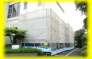
①外壁の様子 足場やフェンスに触らないように！ 工事期間は6月～10月を予定。
